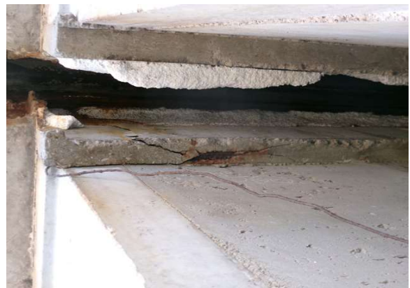
S6 바닥판하면 파손 및 철근노출
