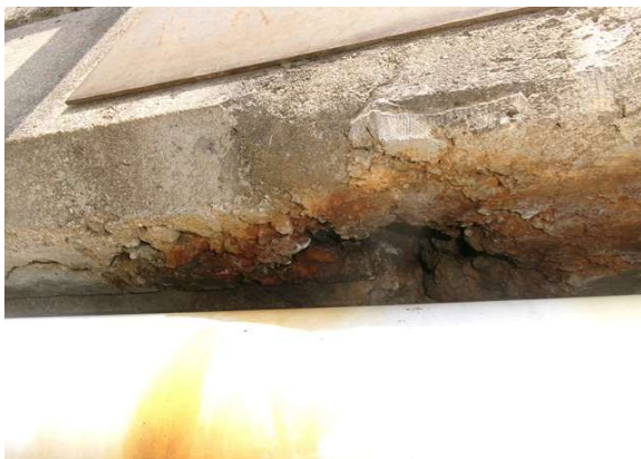
S4 바닥판하면 파손 및 철근노출
